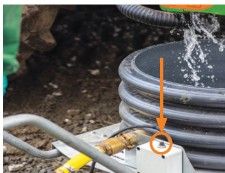
Pour que la pompe ne fonctionne pas à vide, elle s'arrête alors qu'il reste un reliquat d'effluents. Appuyer sur le bouton pour l'évacuer ( 30 secondes maximum ).
